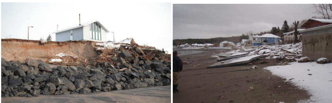
Érosion événementielle malgré la présence d'ouvrages de protection (gauche : Sept-Îles; droite : Sainte-Luce, décembre 2010)
